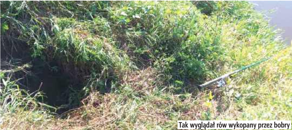
Tak wyglądał rów wykopany przez bobry
