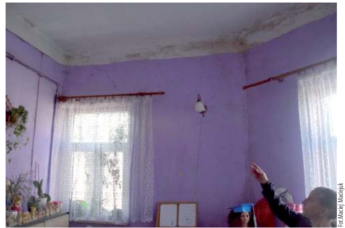
Stan niektórych mieszkań wymaga pilnego remontu
