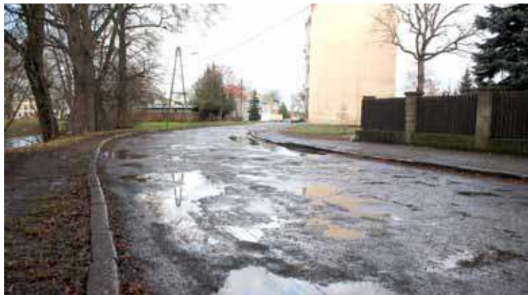
Fatalny stan nawierzchni jest również na Światopełka
