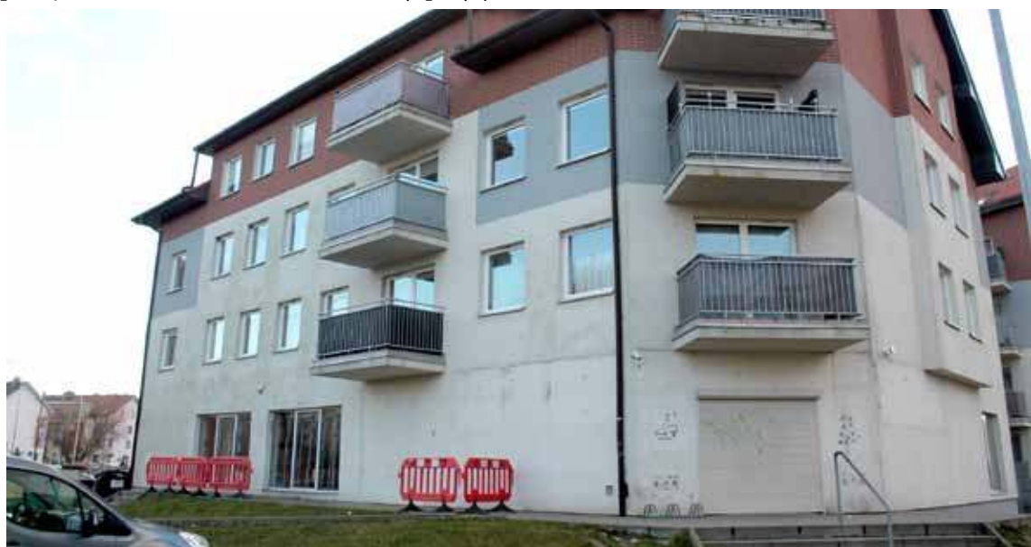
Budynek został zabezpieczony przed dalszym osiadaniem
