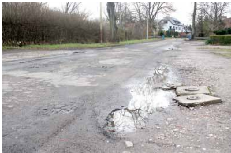
Stan nawierzchni na Drzymały pozostawia wiele do życzenia, a brak chodnika stwarza niebezpieczeństwo dla pieszych
