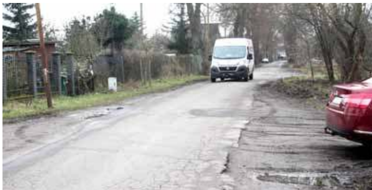
Na pewnym odcinku na ul. Drzymały, droga jest tak wąska, że nie miną się jednocześnie dwa auta. Pobocze jest zdegradowane
