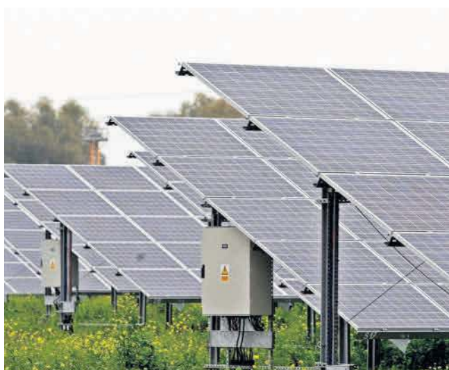
Panele fotowoltaiczne przekształcają energię ze słońca w prąd
