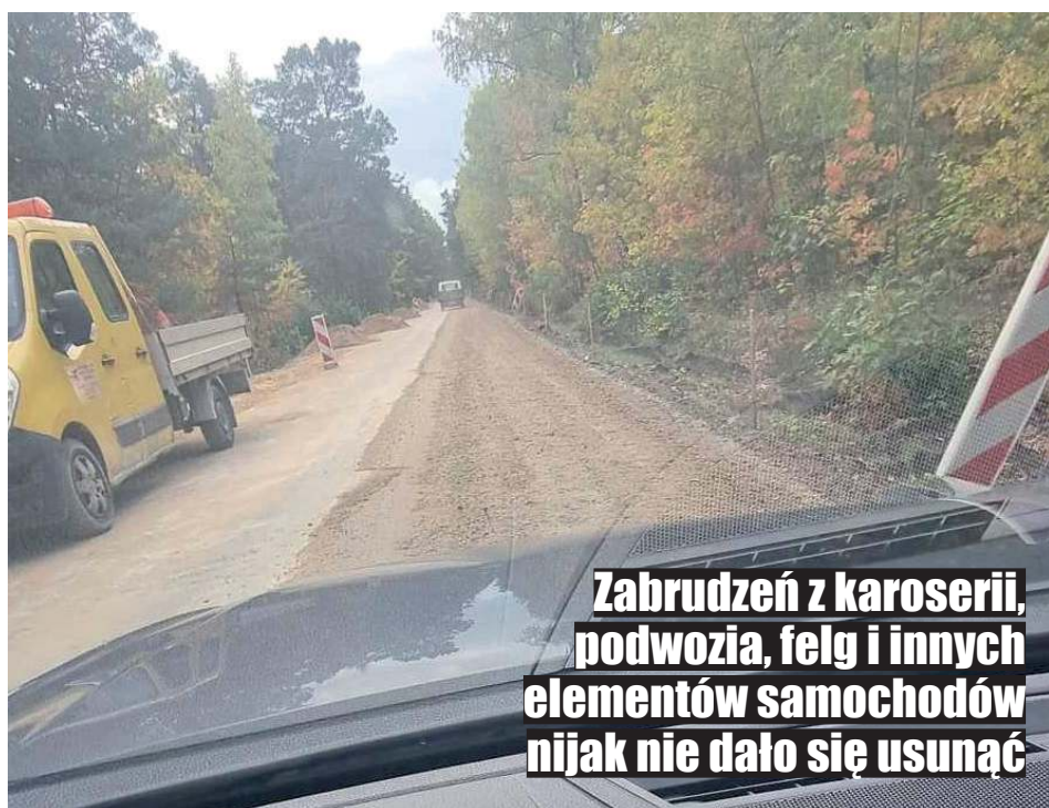
Nasi Czytelnicy zwracają uwagę, że 19 października padał deszcz i nawierzchnia była mokra. Według nich wykonawca zbyt szybko dopuścił ruch na remontowanych odcinkach
