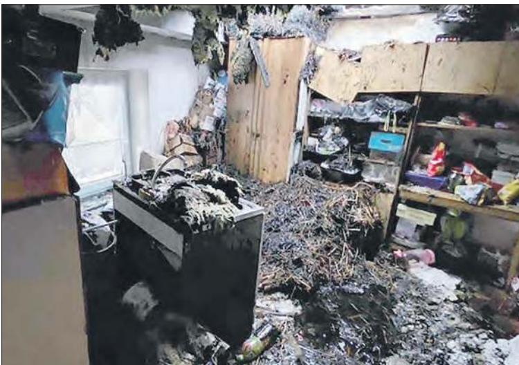
Pożar doszczętnie zniszczył budynek
