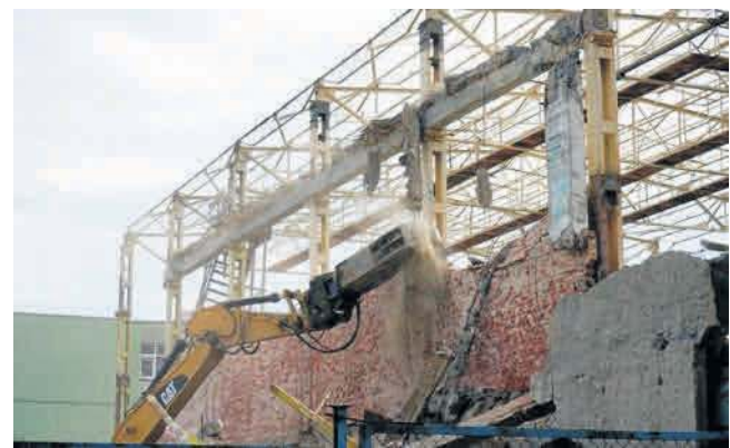
Z dawnego basenu przy ul. Matuszczaka pozostały już tylko resztki konstrukcji
