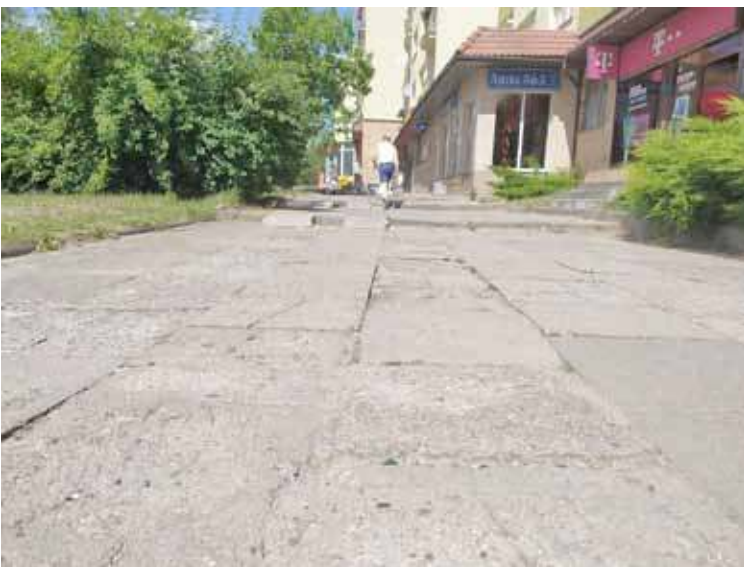
Chodnik zlokalizowany przy ul. Warszawskiej aż prosi się o remont
