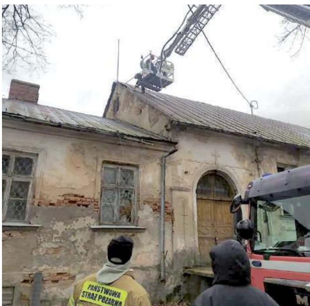
21 lutego, przy uszkodzonym dachu Kirch w Cycowie Kolonii Drugiej pracowały zastępy OSP KSRG Cyców i JRG Łęczna
