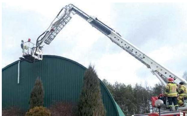
5 lutego, uszkodzony dach w Wólce Cycowskiej. Na miejscu pracowały zastępy z OSP KSRG Cyców i JRG Łęczna
