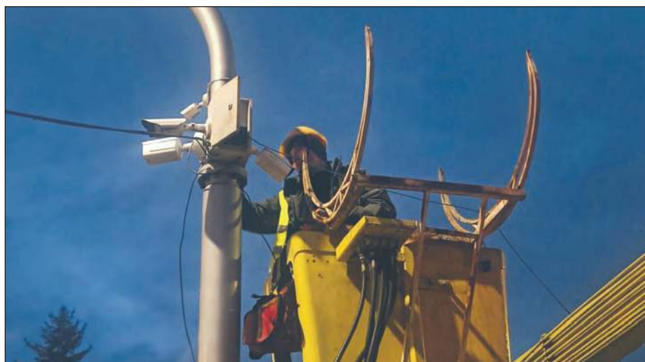
➤ Aktualnie system monitoringu miejskiego w Garwolinie obejmuje 81 kamer, z czego 12 zostało zainstalowanych w ramach ostatniej rozbudowy
