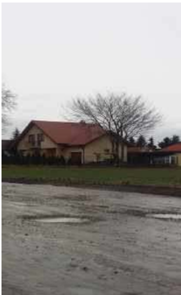
Nim rozpocznie się prawdziwy remont ul. DREWNIANEJ jej mieszkańcy oczekują, że miasto chociaż załata największe dziury
