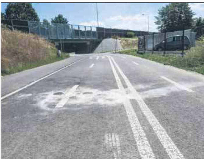
Uszkodzony asfalt jest prawdopodobnie efektem wysokich temperatur
