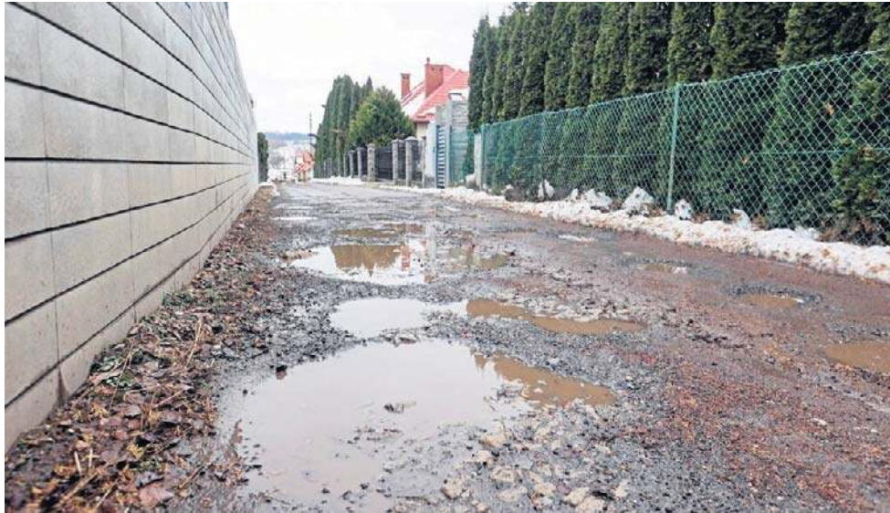
Wąska, dziurawa i nieoświetlona, po deszczu zamienia się w błotnistą drogę
