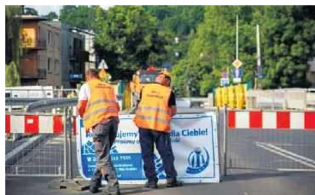
Na przywrócenie normalnego ruchu przez most na Rudawie trzeba będzie poczekać przynajmniej 3 lata
