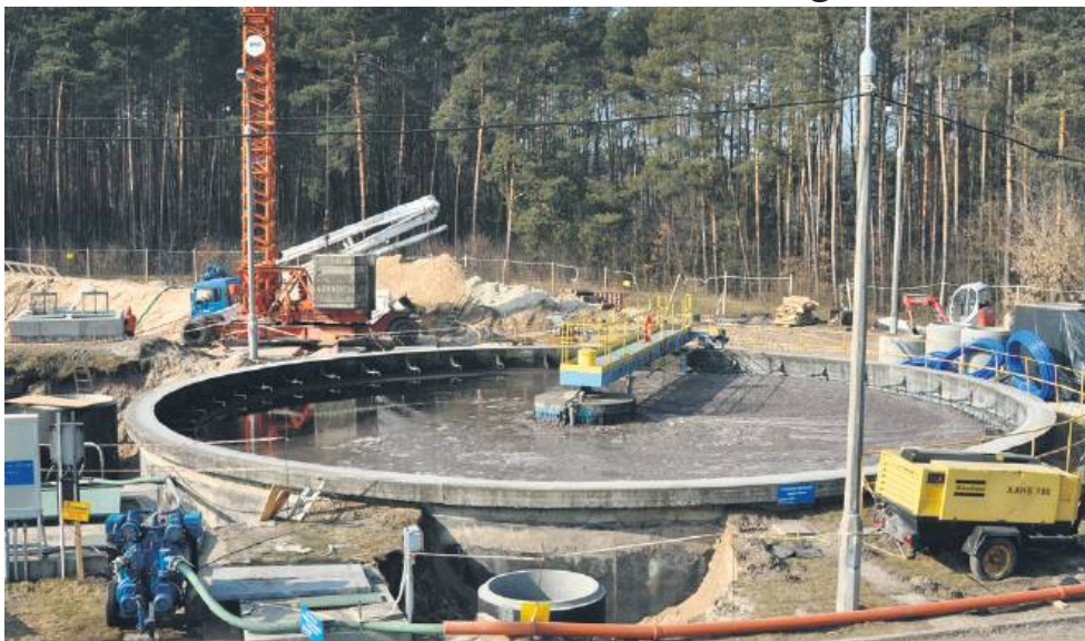
Biłgorajska oczyszczalnia ścieków potrzebuje gruntownej modernizacji. Potrzeba na to 40 mln zł.
