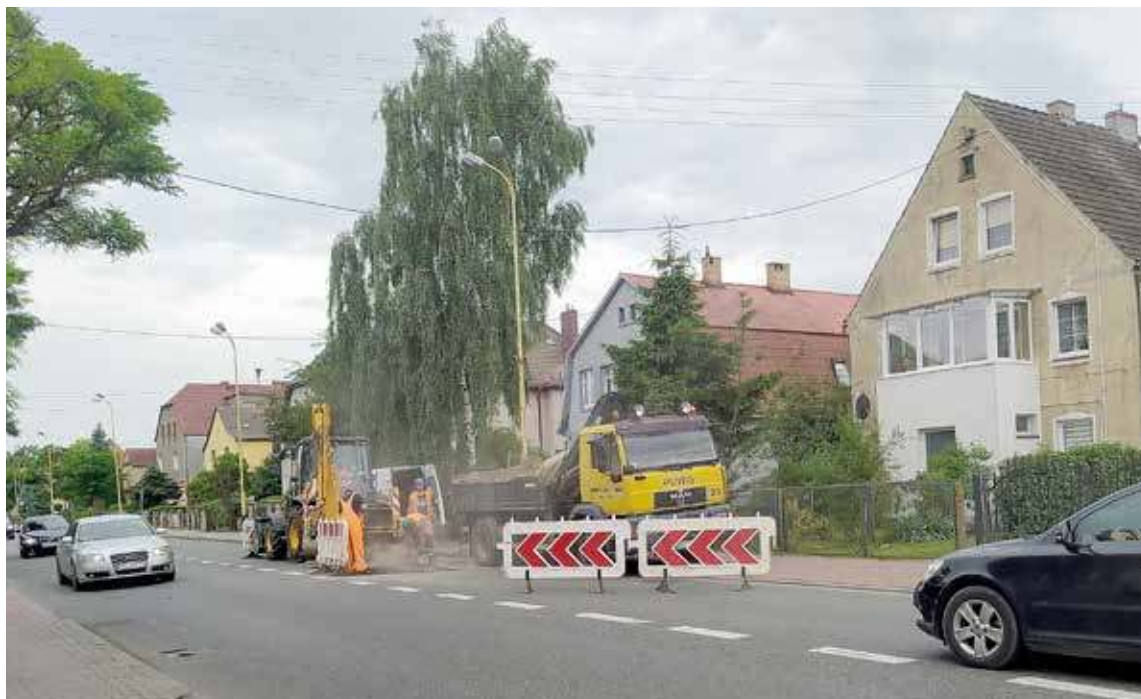
Jedna z licznych awarii usuwanych przez pracowników PUWiS. Nasza sieć wod.-kan. jest zdekapitalizowana wymagając kosztownych inwestycji co może się odbić na cenie wody
