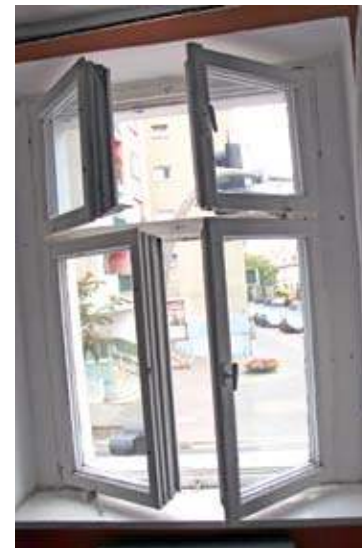
Okna wymagają naprawy
