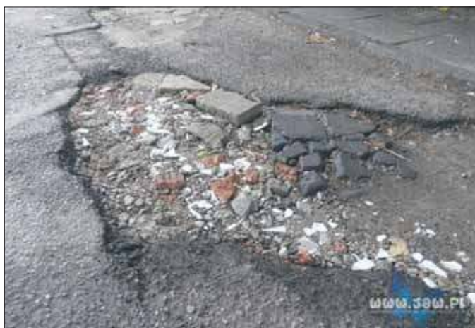
Dziura wypełniona potłuczonymi kafelkami i gruzem
