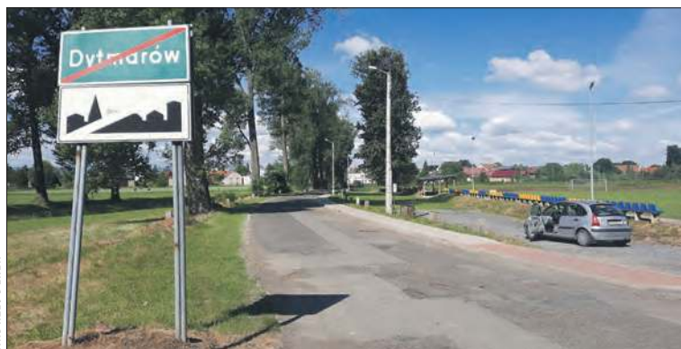
Fragment drogi między Skrzypcem a Dytmarowem czeka generalny remont
