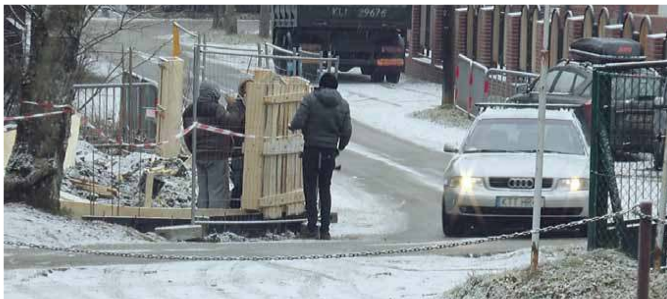
Nowy płot „wcina” się w drogę i utrudnia jazdę kierowcom.
