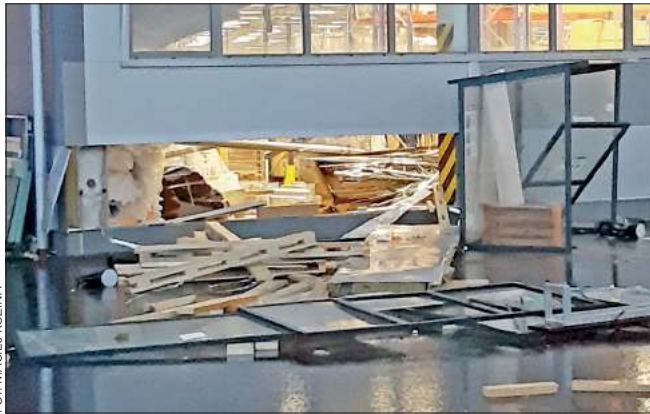
W hali produkcyjnej nr 6 w Eko-Oknach woda wdarła się przez dach do środka zakładu. Na szczęście pracownicy w porę odsunęli się na bezpieczną odległość.
