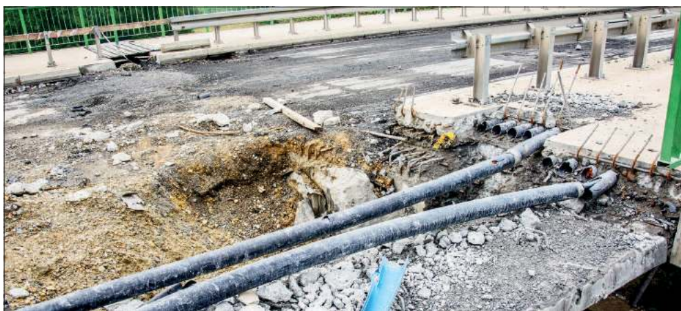
Przy rozbiórce elementów wiaduktu przewidzianych do wymiany, okazało się, że naprawy wymaga jeden z elementów konstrukcji
