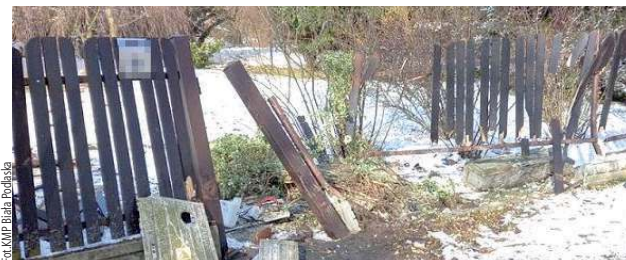
Policjanci dostali zgłoszenie dotyczące uszkodzenia ogrodzenia i skrzynki energetycznej na jednej z posesji w Janowie Podlaskim
