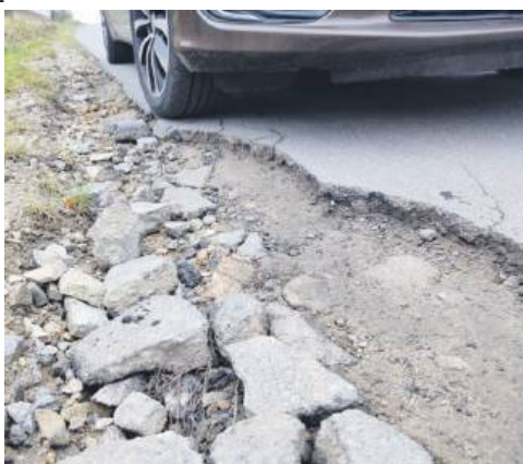
Wzdłuż ulicy Sosnowej w Gęsińcu woda pozrywała asfalt i wyłobila koryto
