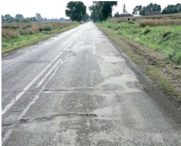
Mocno zniszczona droga powiatowa Tarnawa Mała-Turobin po interwencji mieszkańców doczeka się remontu
