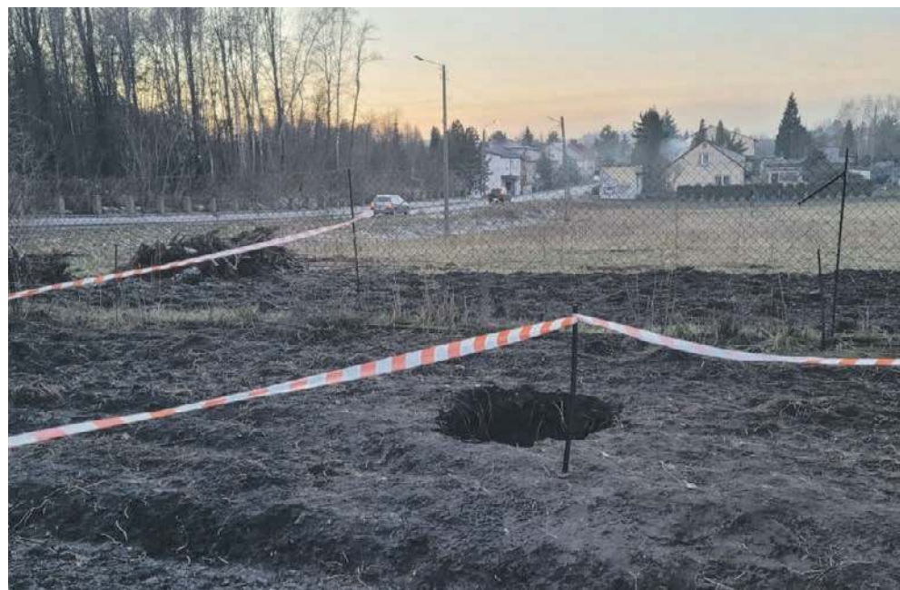
Nowe zapadlisko przy Grunwaldzkiej w Trzebini
