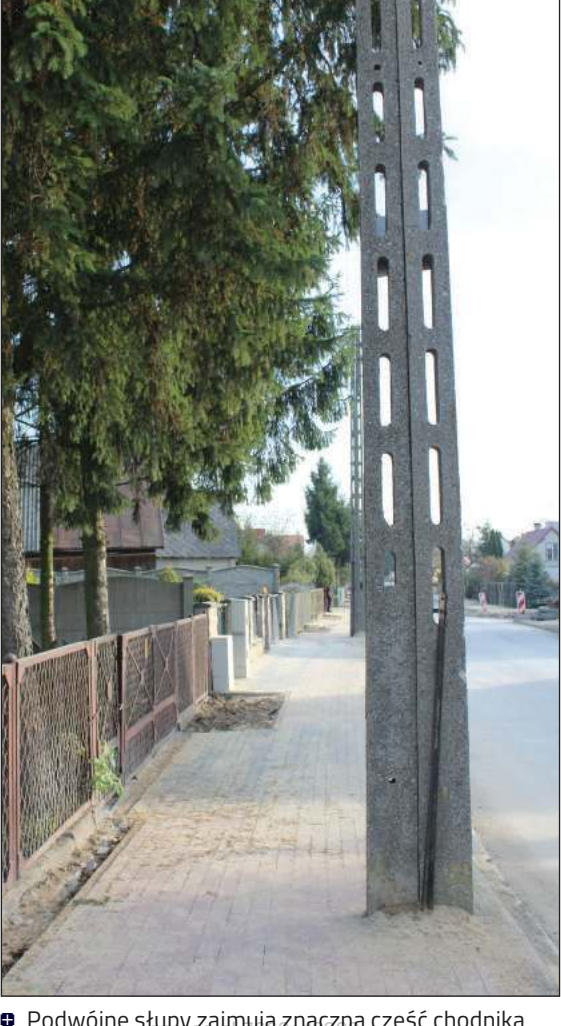
Podwójne słupy zajmują znaczną część chodnika
