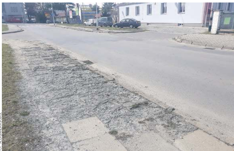
Chodniki w sąsiedztwie wiaduktu w wielu miejscach są w opłakanym stanie
