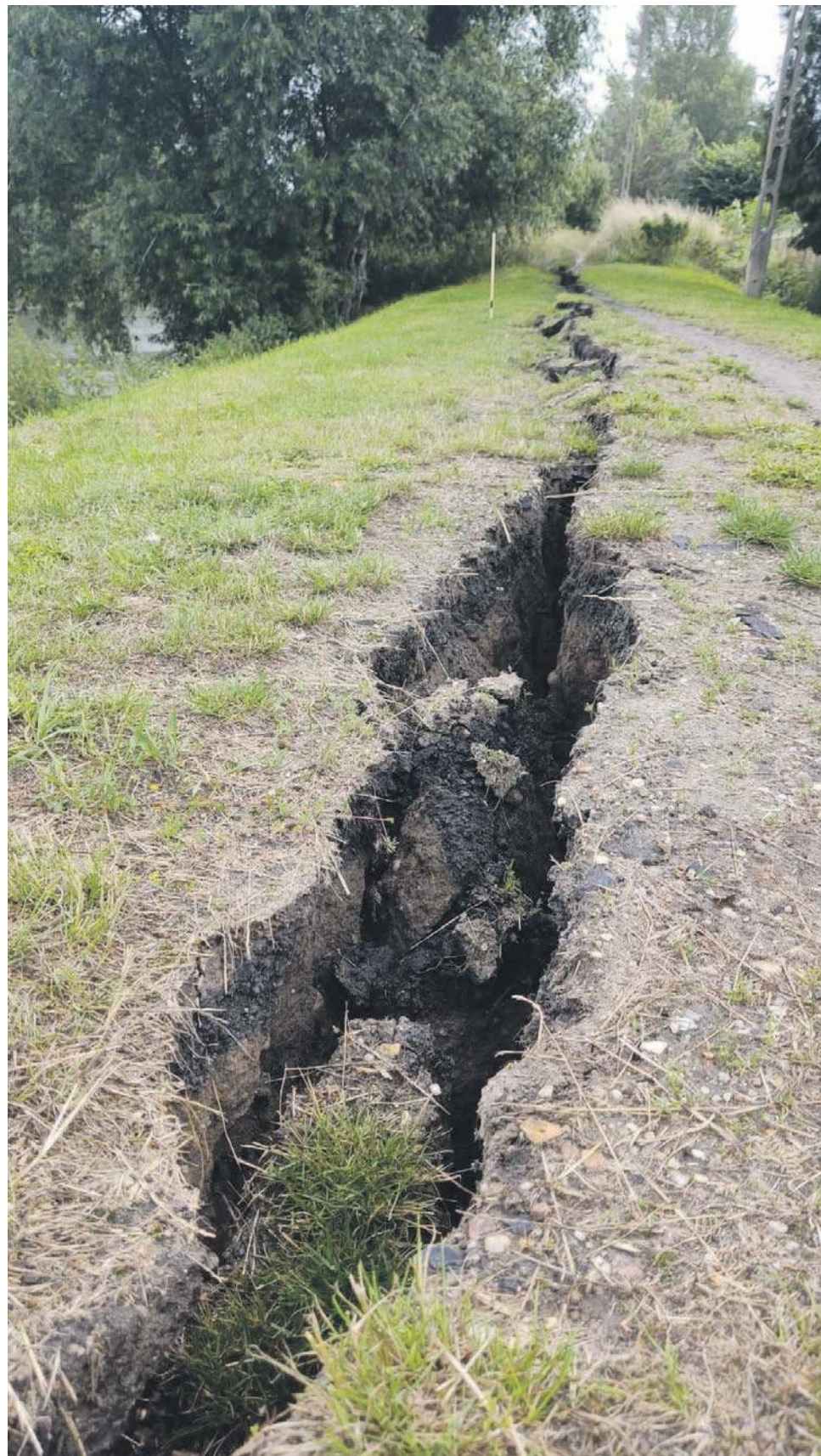
W ciągu kilku godzin pęknięcie wału powiększyło się o kilkanaście centymetrów
