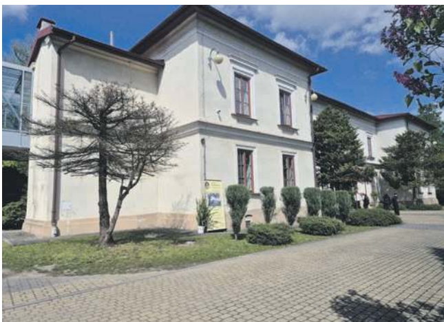
Dach budynku LO czeka remont
