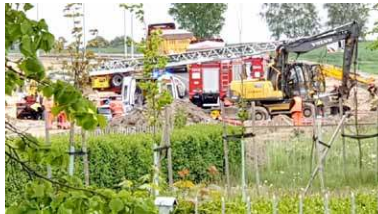
Na placu budowy na 34-latka osunęła się ziemia. Foto Stoja!Stargard
