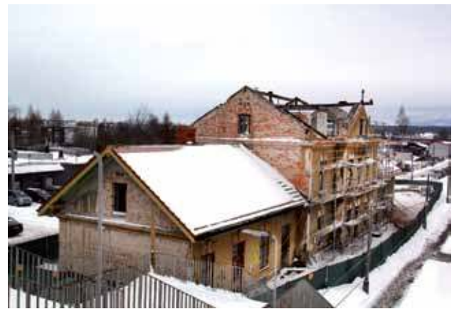
Dworzec kolejowy już bez dachu.
