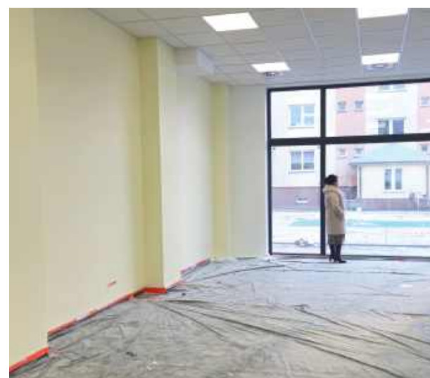
Wójt Anna Mróz w ubiegłym tygodniu wizytowała w budowanym przedszkolu w Kąkolewnicy
