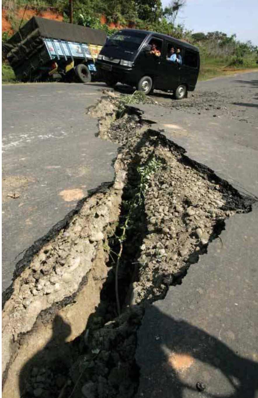
Fot. 2. Indonezja – droga w Lais w prowincji Bengkulu, zniszczona przez trzęsienie ziemi w dniu 12.09.2007 r. o sile 8,4 stopnia w skali Richtera oraz przez wstrząsy wtórne (hipocentrum znajdowało się na głęb. 10 km, a epicentrum w odległości 153 km na południowy zachód od Bengkulu) (fot. PAP EPA/Mast Ihram)
