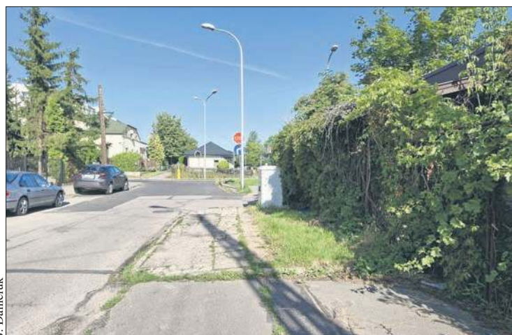
Część ulicy Lasockiego wymaga remontu
