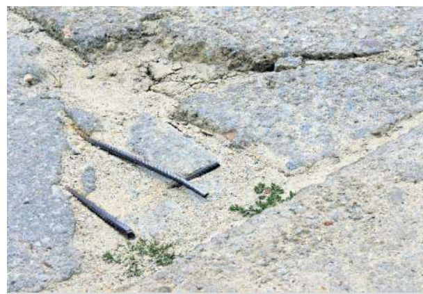
Wystające druty zbrojeniowe mogą uszkodzić samochód i doprowadzić do wypadku
