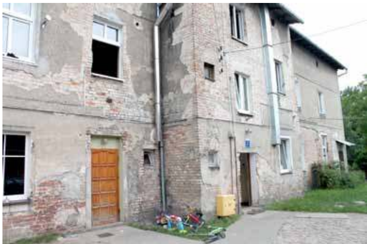
Jak widać elewacja budynku kamienicy przy ul. Towarowej 7 pozostawia wiele do życzenia
