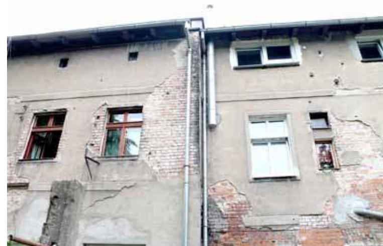
Tynk odpada płatami od ściany
