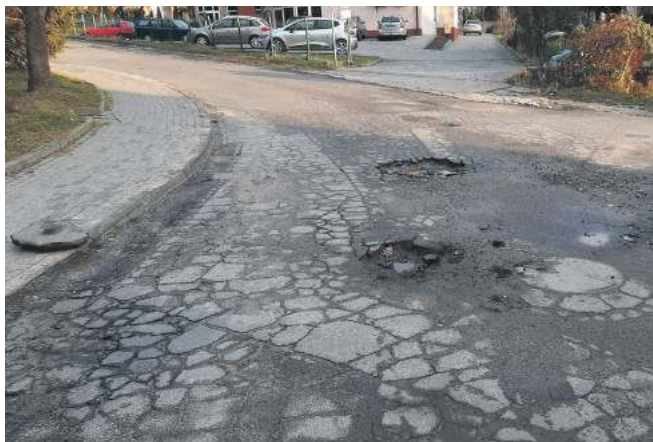
Te dziury na ul. B. Chrobrego są od dłuższego czasu. Asfalt wykrusza się na całej szerokości jezdni. Jeszcze trochę i powstanie tu jedna duża dziura
