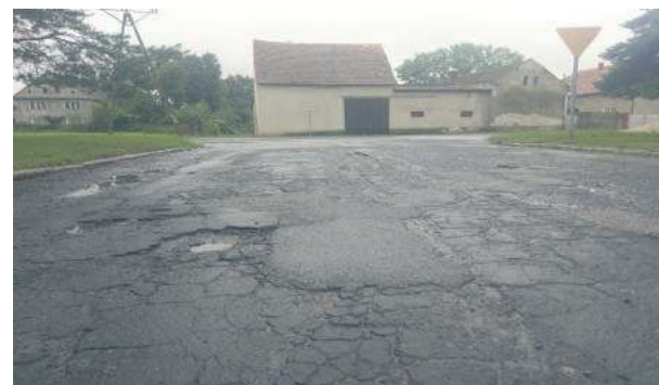
Popękana nawierzchnia w okolicach skrzyżowania w Kucharzowicach
