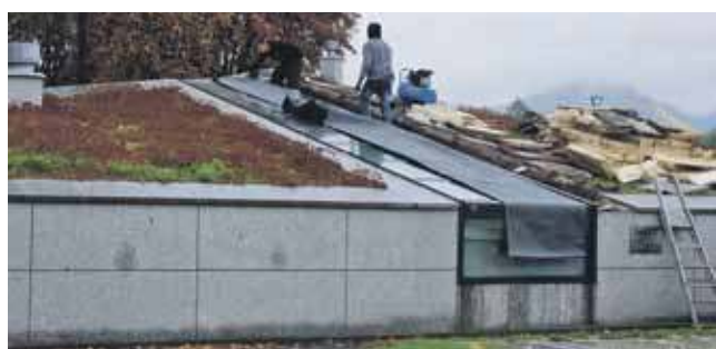
Cieknie z dachu na klienta, robotnicy muszą naprawić fuserkę.
