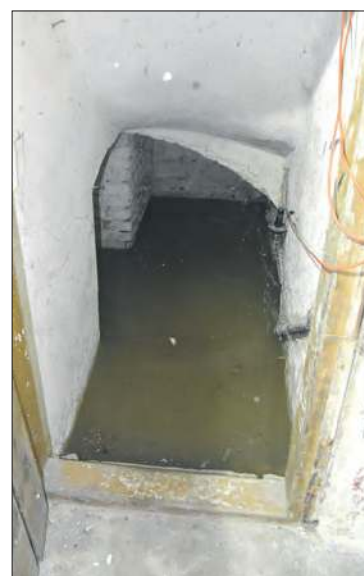
Piwnica całkowicie wypełniona wodą
