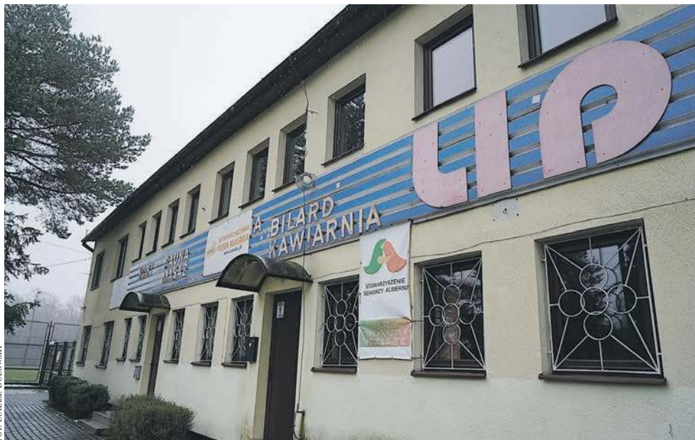
Budynek na stadionie w Alwerni wymaga remontu
