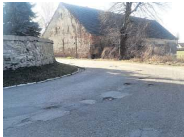
Ubytki w nawierzchni drogi powiatowej zagrażają bezpieczeństwu mieszkańców
