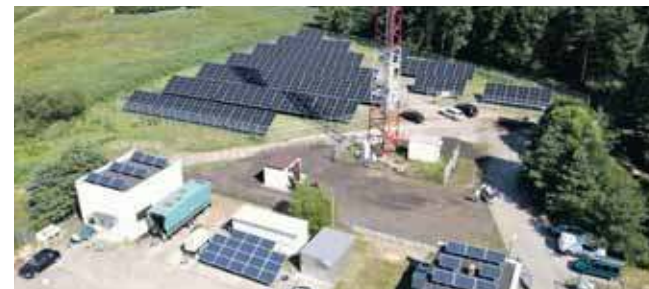
W Kaletach powstała największa w powiecie instalacja fotowoltaiczna. Czy miasta będą odsprzedawać sobie energię elektryczną uzyskaną w ten sposób?
