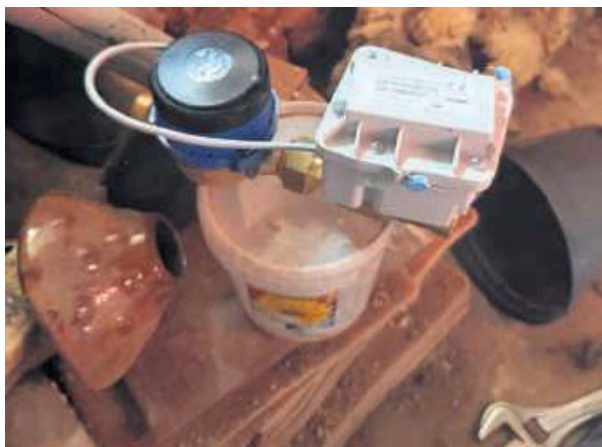
Na posesjach niektórych mieszkańców gminy montowane są liczniki przedpłatowe (Foto: ZUK Kondratowice)
