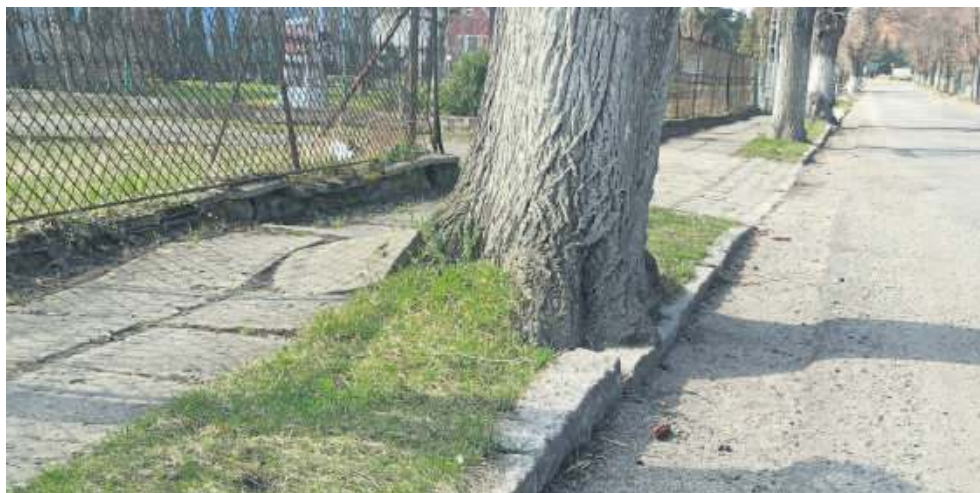
Chodnik w Starym Wiązowie wymaga remontu. Gmina Wiązów przekazała na to zadanie dotację dla powiatu strzelińskiego
