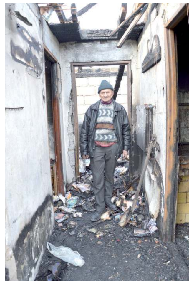
W domu znajdowały się kuchnia, łazienka oraz pokój i przedpokój. Wszystko niemal doszczętnie strawił pożar. - Nawet grzejnik na ścianie się stopił. Jakaż to musiała być temperatura! - mówi pogorzelcec. Przed murowanym budynkiem był drewniany ganek. Nic z niego nie zostało
