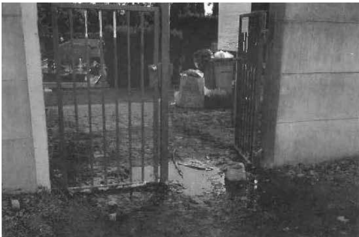
Ukształtowanie przejścia przy bramce do sektora D -14 tworzy nieckę, która po opadach deszczu wypełnia się wodą i utrudnia przejście przez czasami kilka dni
