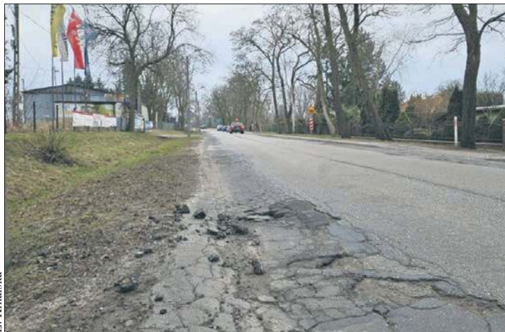
Ulica Sierpecka wymaga pilnego remontu. Na razie powstaje projekt tego przedsięwzięcia, który ma być gotowy jesienią tego roku
