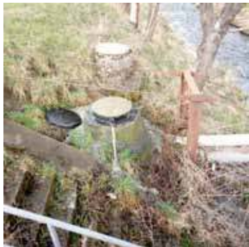
Zapchana przepompownia spowodowała wyciek ścieków do rzeki
