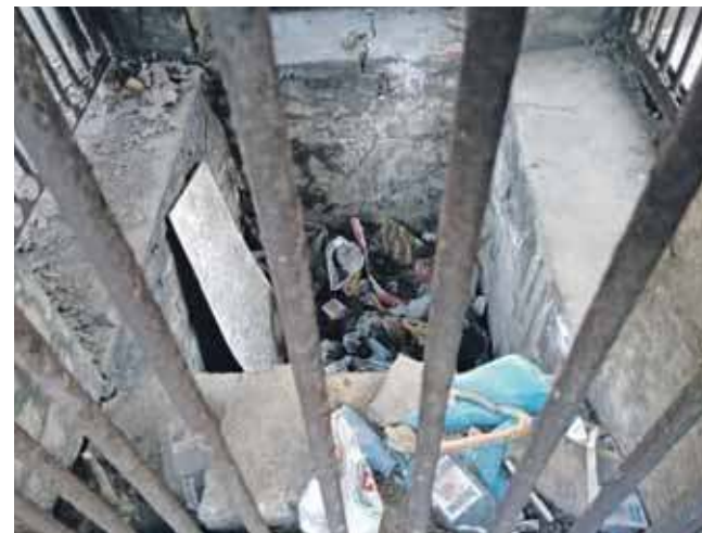
Wylot wyjścia awaryjnego bardziej przypomina śmietnik niż budowlę ochronną
