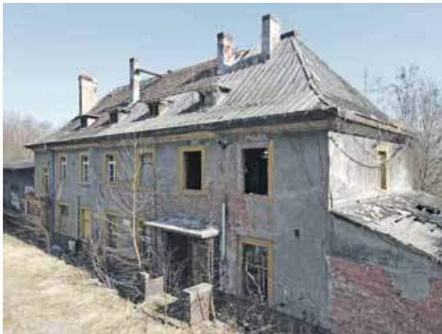
Pozostawiony na pastwę losu dworzec kolejowy w Miedarach
