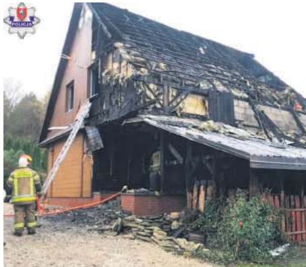
Wstępne straty oszacowano na 400 tys. zł. Przyczyną pożaru mógł być nieszczęśny przewód dymowy.
